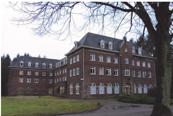
Het gebouw Sint Theresia verkeert in deplorabele staat
